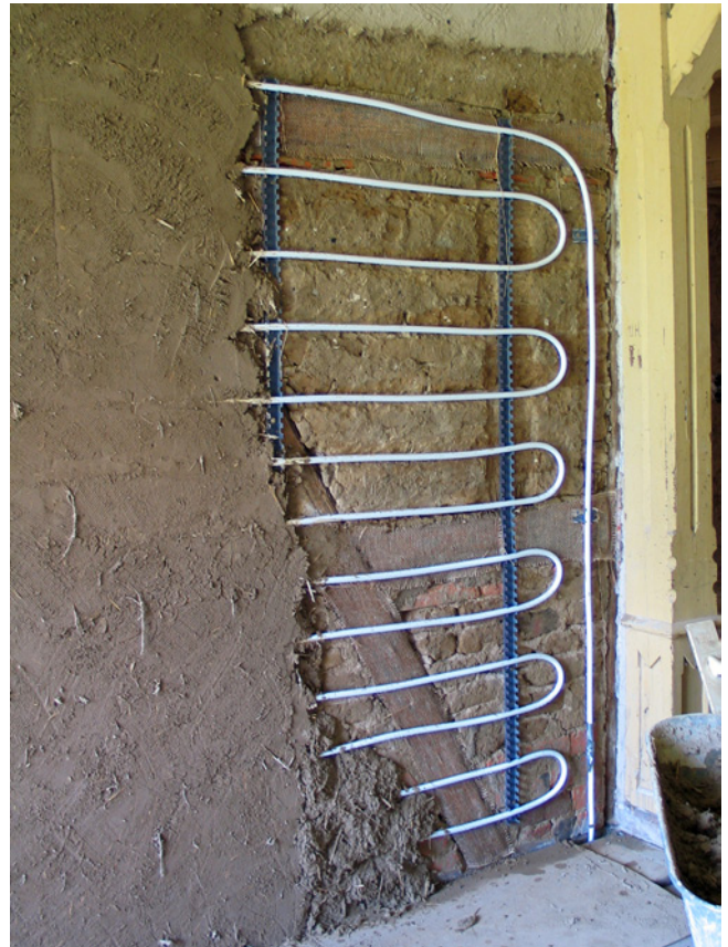
Wandflächenheizung in einem älteren Fachwerkbau.
